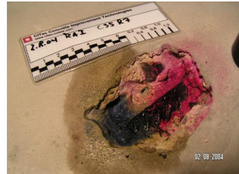
Realkalisierung des Betons um einen Bewehrungsstahl (CITec GmbH)
