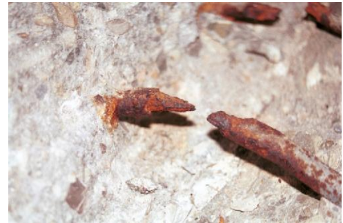
Durch Chloridangriff zerstörte Bewehrung
